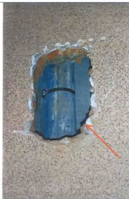
Фото№10. Вскрытие перегородки в квартирном холле для устранения протечки
