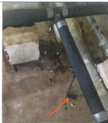
Фото№6. Следы протечки на перекрытии.
