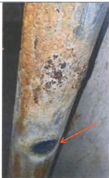
Фото №13. Подтеки и устраненная с помощью сварки протечка на главном стояке секции
