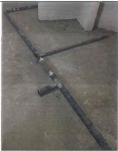
Фото№3. Замененный участок трубы с большим количеством свищей
