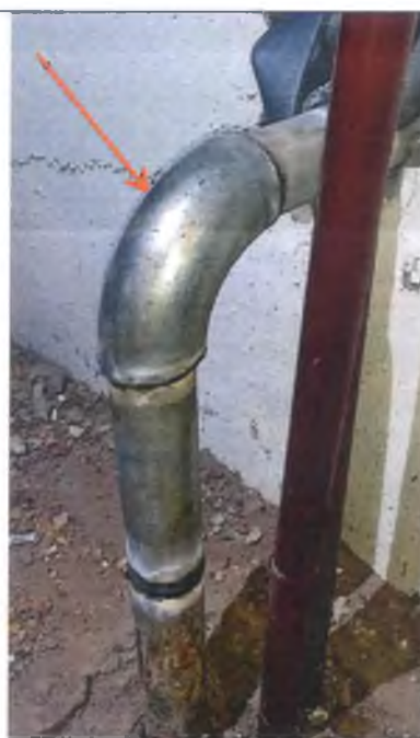
Фото №12. Замененный элемент системы горячего водоснабжения
