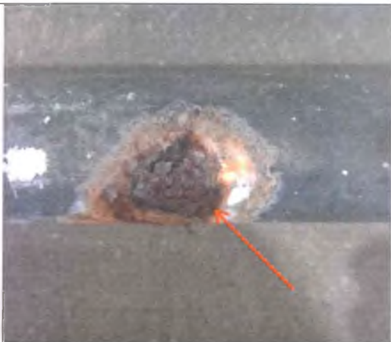
Фото№5. Свищ на замененном участке трубы.
