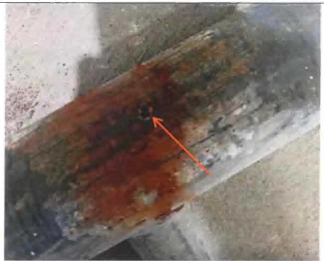
Фото№2. Вскрытый коррозионный свищ
