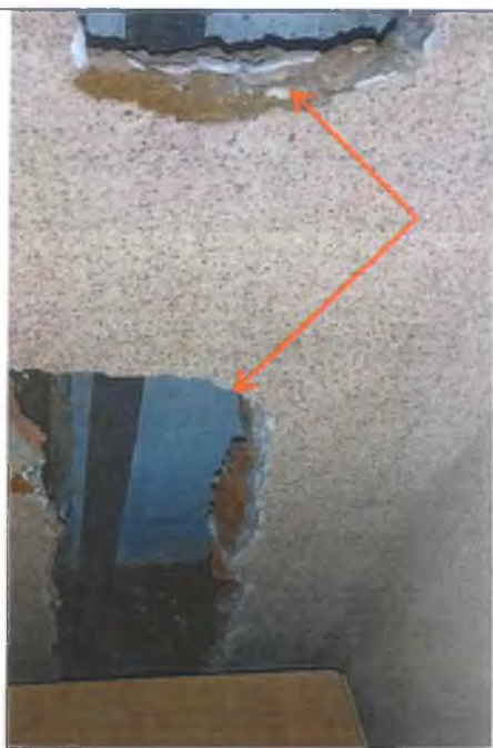
Фото 11. Вскрытие перегородки в квартирном холле для устранения протечки
